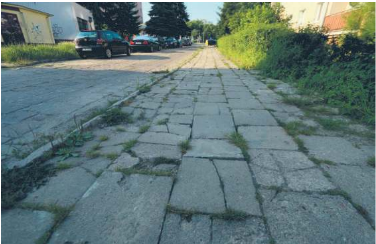
Miasto deklaruje, że zdewastowana jezdnia i chodniki przy Kalinowej jeszcze w tym roku zostaną wyremontowane
