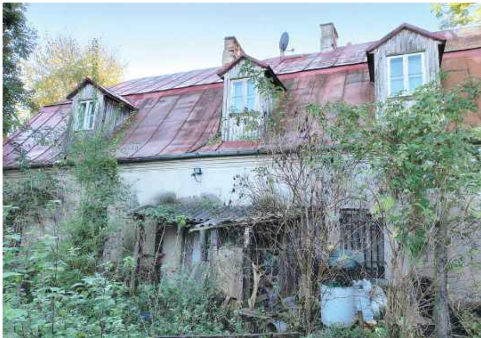
Przed oczyszczaniem kamieniczka wyglądała na bardzo zaniedbaną
