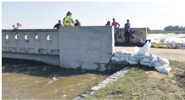
Chodzi o ten most, uszkodzony podczas ubiegłorocznej powodzi
