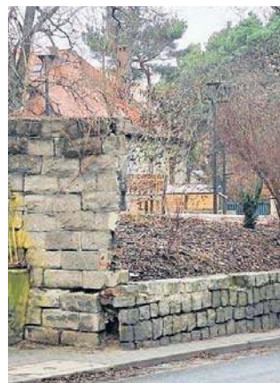
W złym stanie jest murek oporowy wzdłuż ulicy Matejki w Toruniu
