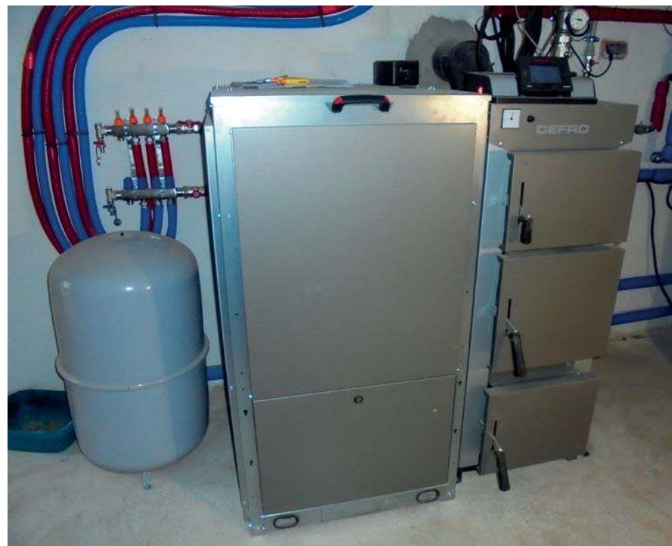
Kotłownia na pellet dofinansowana z Programu Czyste Powietrze
