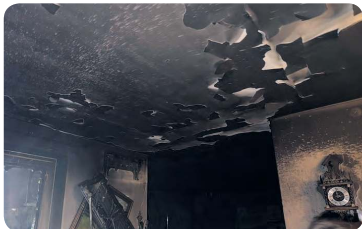
Rodzina opowiada nam, że ogień przenosił się po suficie do wnętrza budynku.
