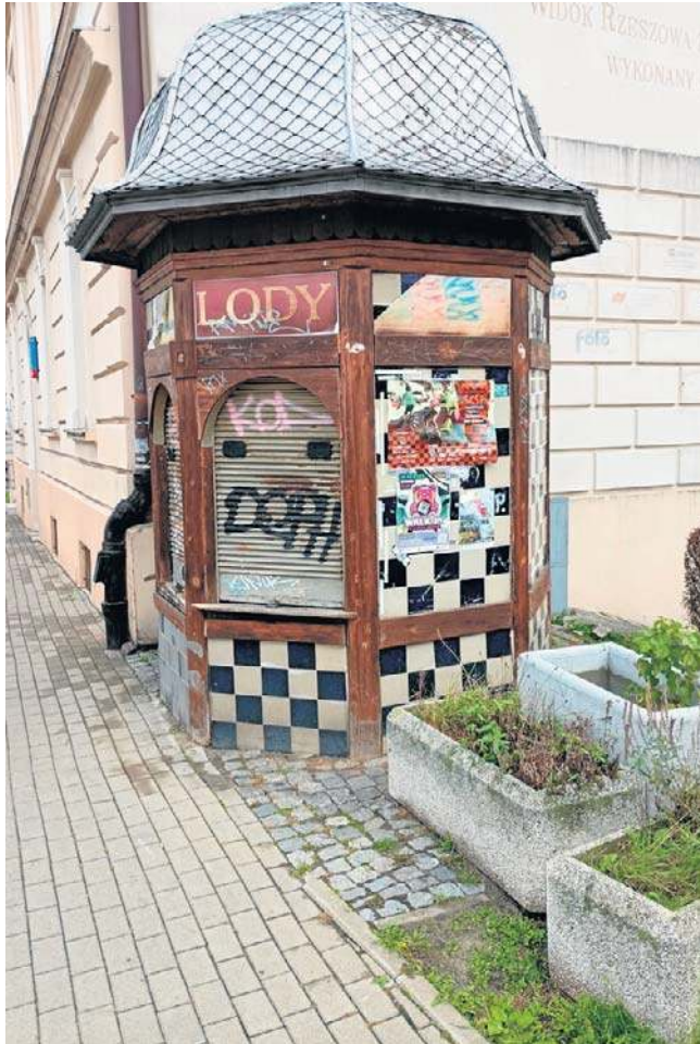
Trafika w obecnym stanie nie przypomina zabytkowego obiektu z początku XX wieku
