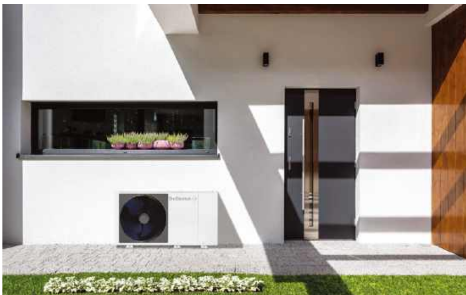
❶ Pompa ciepła to urządzenie ekologiczne i niedrogie w eksploatacji, bo wykorzystuje energię z otoczenia, która jest darmowa. DE DIETRICH
