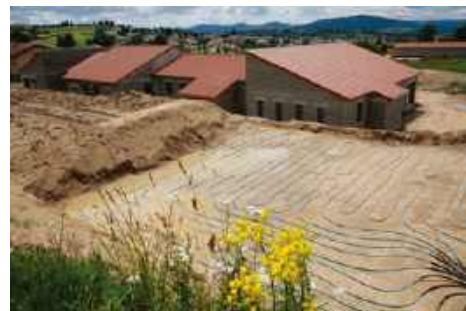
📍 Na poziomy kolektor gruntowy musimy przeznaczyć sporo miejsca i rozkopać działkę. Za to zyskujemy stabilne i wydajne źródło dolne. DE DIETRICH (SOFATH)
