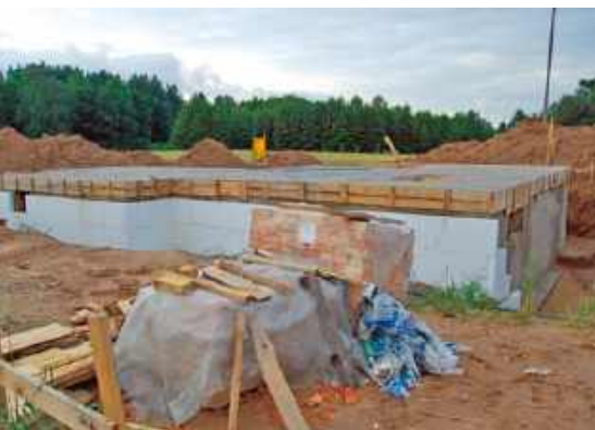
🔧 Wykonanie izolacji przeciwwodnej piwnicy jest trudne i drogie, dlatego obecnie wielu inwestorów rezygnuje z tego pomieszczenia. ARCHIWUM BD
