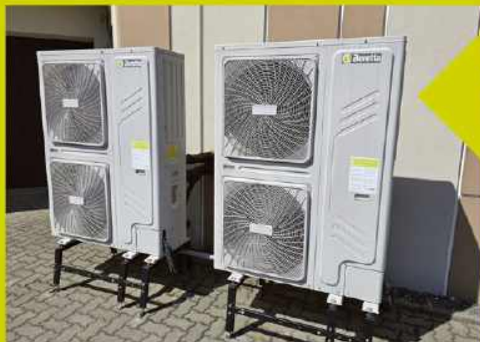
Dwie pompy ciepła HYDRO UNIT M 030T Budynek biurowy Osielesko
