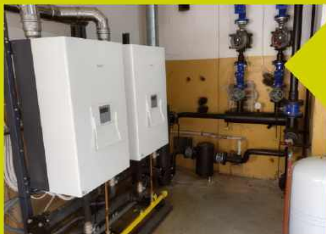
Dwa kotły POWER MAX o łącznej mocy 160 kW Wspólnota mieszkaniowa Wąsosz
