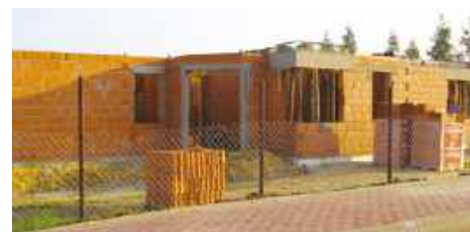
📍 W miejscach szczególnie obciążonych, takich jak nadproża, wieńce stropowe i wąskie filary stosuje się beton zbrojony. Tu priorytetem jest wytrzymałość. ARCHIWUM BD
