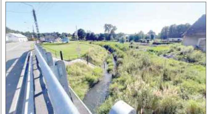
■ Sprawdziliśmy, jak Sumina wygląda na wysokości mostu w ciągu drogi wojewódzkiej nr 922. Wydaje się, że również w tym miejscu rzeka potrzebuje prac konserwacyjnych.
