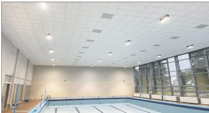
■ Dach nad pływalnią w Zespole Szkół w Miętnej częściowo się ugiął. Sytuacja pogorszyła się po sierpniowych ulewach, kiedy na dachu zgromadziła się woda. Obiekt został wyłączony z użytkowania (fot. Powiat Garwoliński)
