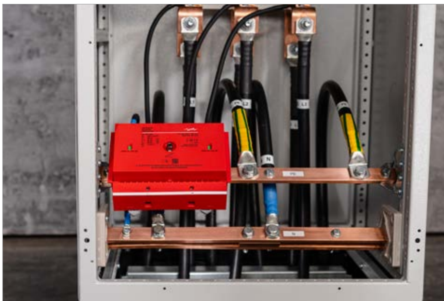
Rys. 2. Ochrona przepięciowa w głównej szafie rozdzielczej na granicy stref LPZ 0/LPZ1: kombinowany ogranicznik przepięć typu T1+T2+T3 (DEHNventil ACI)
