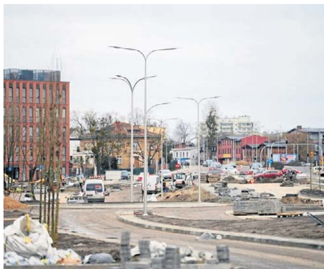
Nowa trasa (na zdjęciu w trakcie budowy) ma odciążać rejon Placu NOT-u i inne skrzyżowania w okolicy
