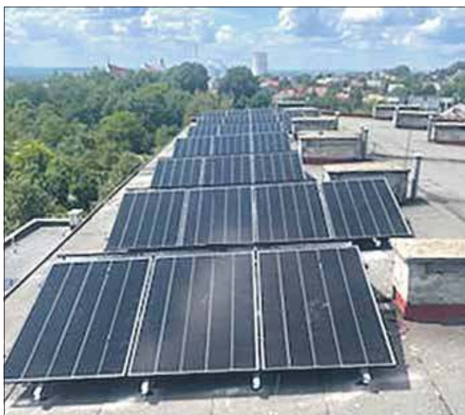
Instalacja fotowoltaiczna (fot. SP ZOZ Szpital Wielospecjalistyczny w Jaworznie)
