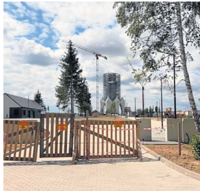
Część terenu jest już gotowa - utwardzona, z małą architekturą i nasadzeniami drzew
