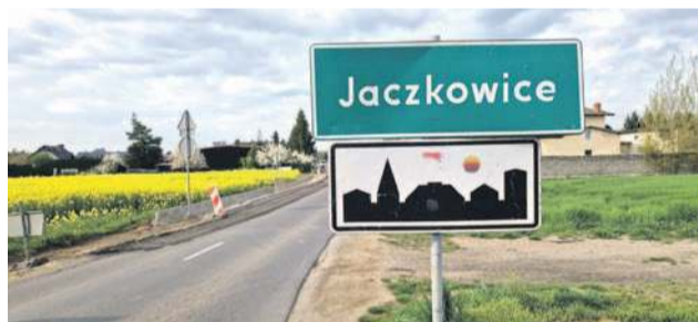
Remont drogi powiatowej nr 1574D, ul. Oławska w Jaczkowicach, już się rozpoczął
