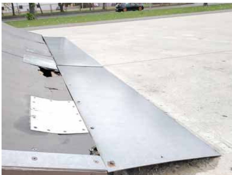
Miejscami widać nawet wystające gwoździe
