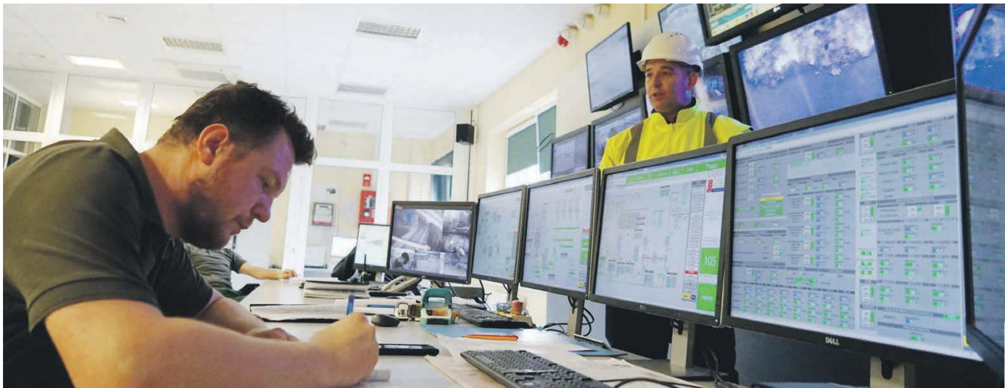
Pracownicy obserwują na bieżąco proces spalania odpadów i emisję spalin
