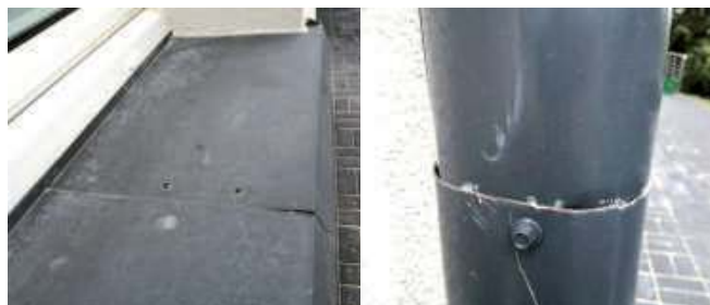
Tak firma remontująca budynek Urzędu Gminy w Wąwolnicy zamontowała parapety, a tak rynny spustowe. Mieszkańcy wskazują także na braki w elewacji
