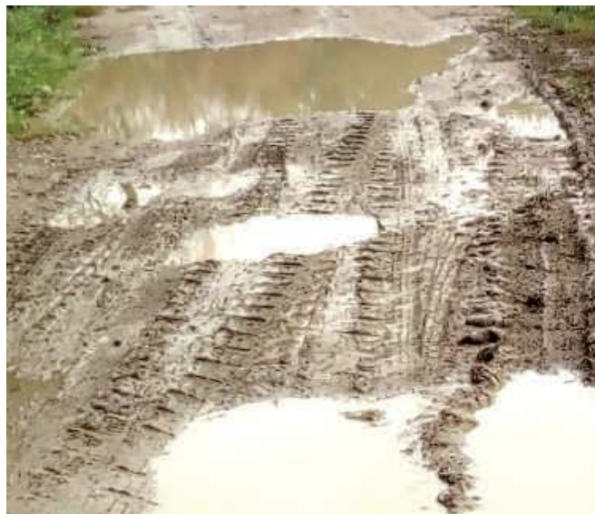
- Na całej długości drogi wytworzyły się doły, w których zbiera się woda, tworząc rozlewiska – opisuje sytuację Włodzimierz Niedźwiecki
