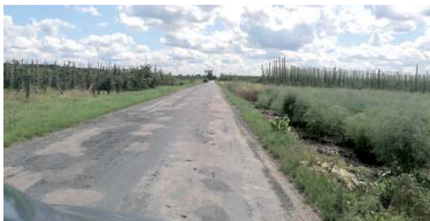
Tak wygląda obecnie nawierzchnia drogi łączącej Dobrze z Wólką Polanowską. Aż prosi się o remont
