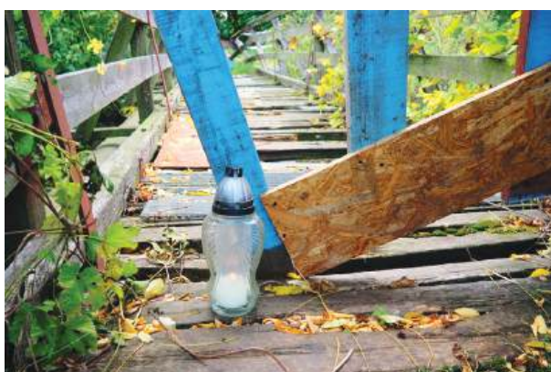
Kładka, na której doszło do śmiertelnego wypadku
