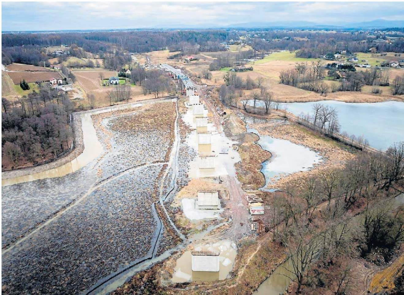
Nowy most kolejowy powstaje w Zebrzydowicach. Gotowe są niemal wszystkie podpory i przyczółki obiektu
