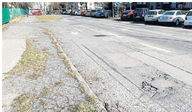
Nawierzchnia ul. Struga jest pełna łat i ubytków
