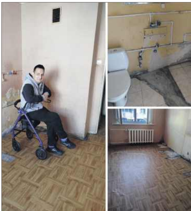
■ Mieszkanie przy Kokoszyckiej wymaga gruntownego remontu
