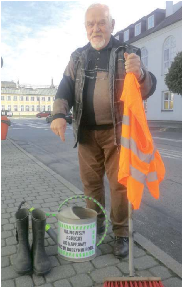
Krzysztof Wysokiński wie, że źródłem jego problemu są nie tyle deszcze, co brak odpowiedniego odpływu wód i za wysoko zamontowana studzienka burzowa. Spodziewał się remontu ulicy, a nie tego, że pracownicy PUK zalepią wybiórcze spęknięcia masą BORNIT z konewki. By nie siedzieć bezczynnie, znany ze zdolności manualnych i pomysłowości zegarmistrz, przygotował samodzielny zestaw naprawczy ulic. Na wzór sprzętu, którym pracownicy PUK łatali dziury w drodze...
