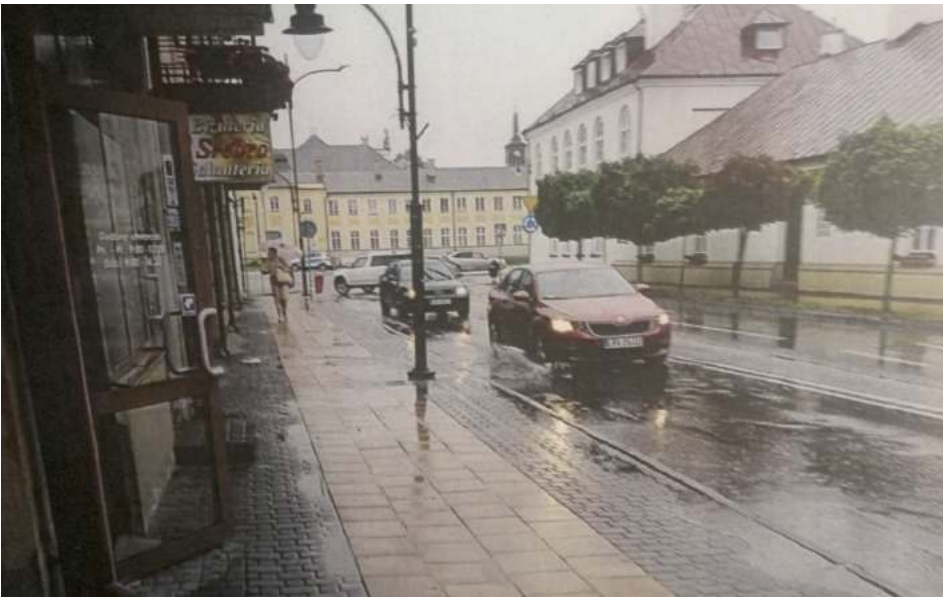
Właściciel lokalu informował magistrat, że główną i jedyną przyczyną zalewania jego budynku jest degradacja podbudowy oraz nawierzchni bitumicznej na odcinku ok. 25 m. Prosił burmistrza o powołanie komisji w celu przeprowadzenia wizji lokalnej „w trakcie lub po opadach deszczu” w jego obecności
