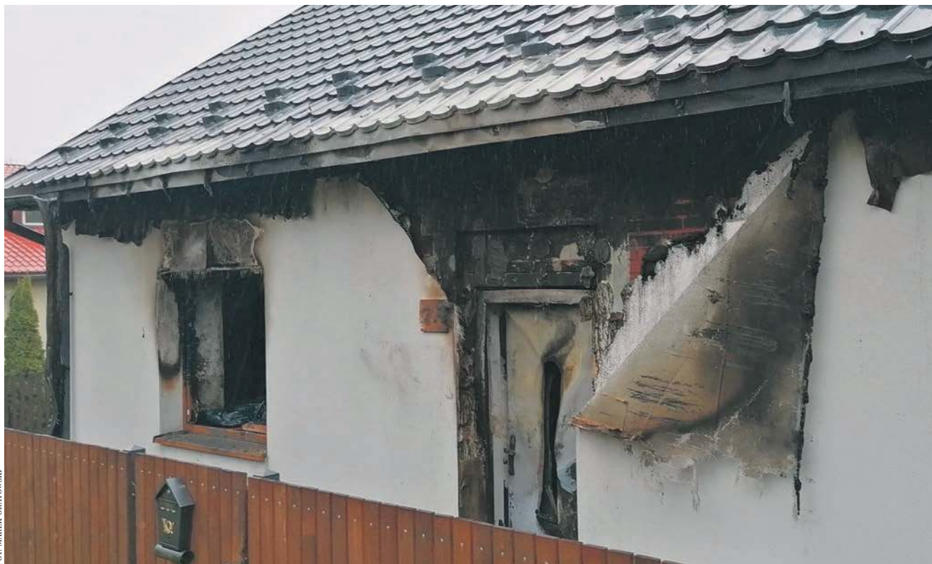
Tak wyglądał spalony dom na Kątach dwa dni po pożarze
