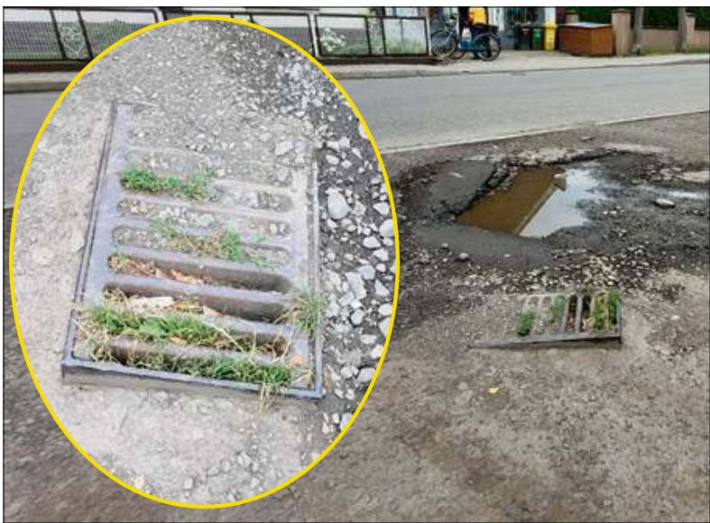
Studzienka kanalizacyjna jest niedrożna.
