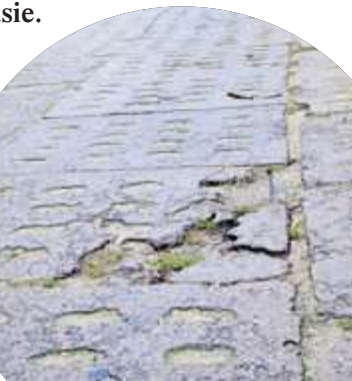
Drogę póki co pokrywają płyty yomb. Nawierzchnia jest w nieciekawym stanie.
