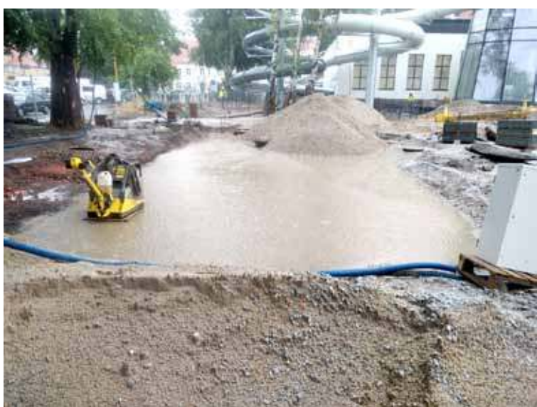
Mimo, że podczas zeszłotygodniowej ulewy na placu budowy przy pływalni powstała tak ogromna kałuża, to tylko niewielka ilość wody dostała się do środka
