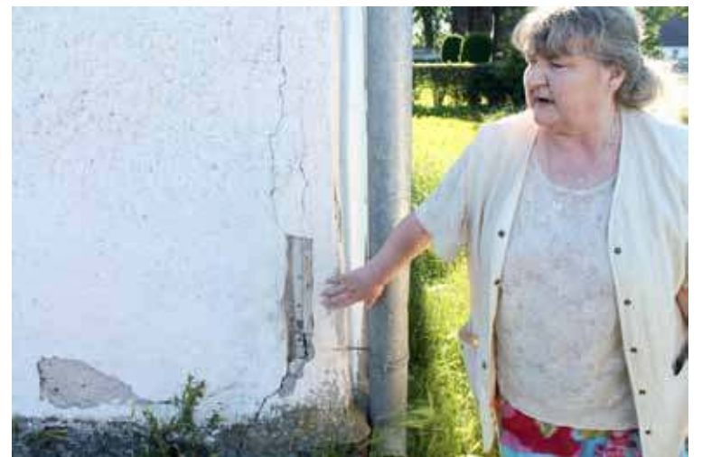
Mieszkanka żąda od gminy likwidacji powstałych uszkodzeń
