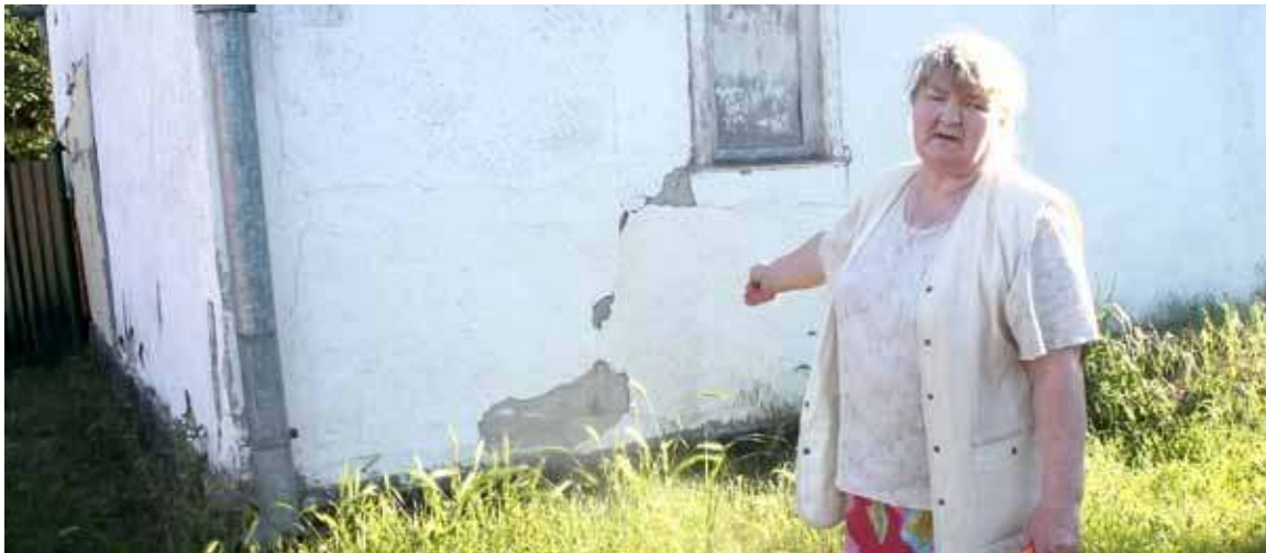
Pani Jadwiga Bagińska pokazuje pęknięcia i odpadający tynk od ściany jej domu, powstały, jak twierdzi, w wyniku drgań wywołanych przez pojazdy poruszające się po uszkodzonej drodze
