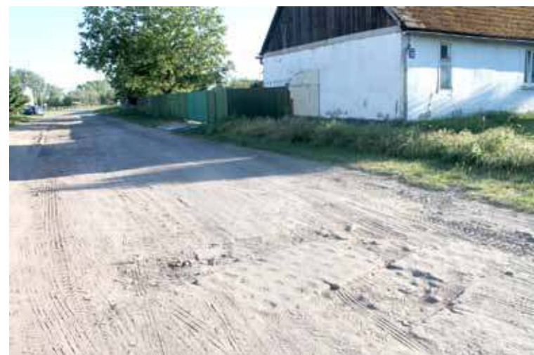
Uszkodzone po przekopie płyty jumbo, z których zbudowana jest droga biegnąca obok posesji pani Jadwigi
