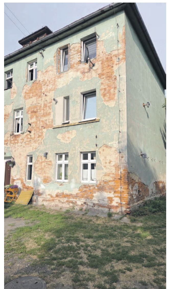
Kamienica przy ul. Wilczej 6 już ponad 10 lat czeka na remont, a... konkretnej daty wciąż nie ma
