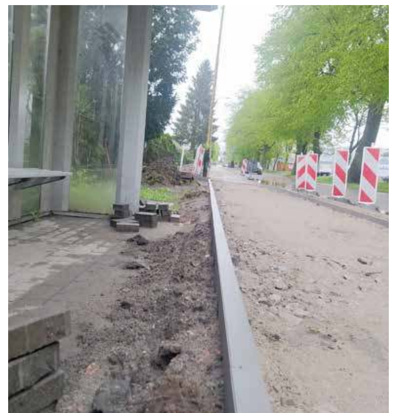
Widoczny na zdjęciu wstawiony nowy próg to zapowiedź znacznej różnicy wysokości poziomów, co może być utrudnieniem dla osób niepełnosprawnych ruchowo
