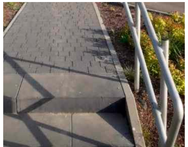
Na ustawionych zaledwie kilka miesięcy temu barierkach już pojawiła się korozja
