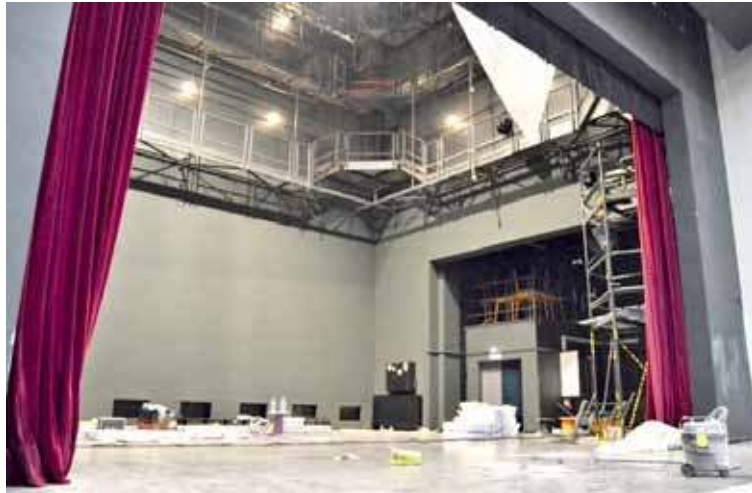
W SCK trwa instalacja nagłośnienia najwyższej jakości. Dzięki niemu dźwięk będzie się rozchodził równomiernie
