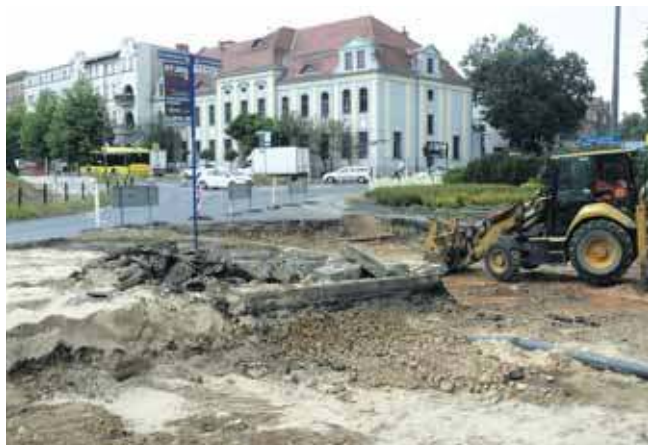
Przyczyną problemów są pozostałości fundamentów dawnego budynku, który kiedyś stał w miejscu, gdzie powstało rondo
