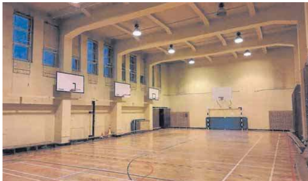
Duża sala gimnastyczna już od dawna nadawała się do remontu
