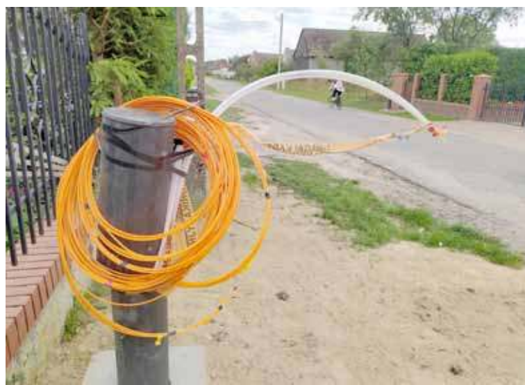
W Dąbrowie nie ma problemu, gdyż kabel poprowadzony był pod ziemią
