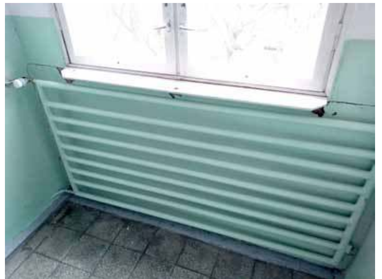
Na każdym piętrze w opisywanym budynku znajdują się grzejniki tej wielkości
