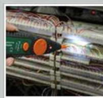
podświetlenie miejsca pracy
