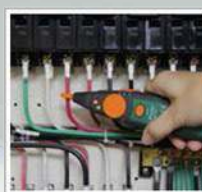
bezprzewodowa detekcja napięcia
