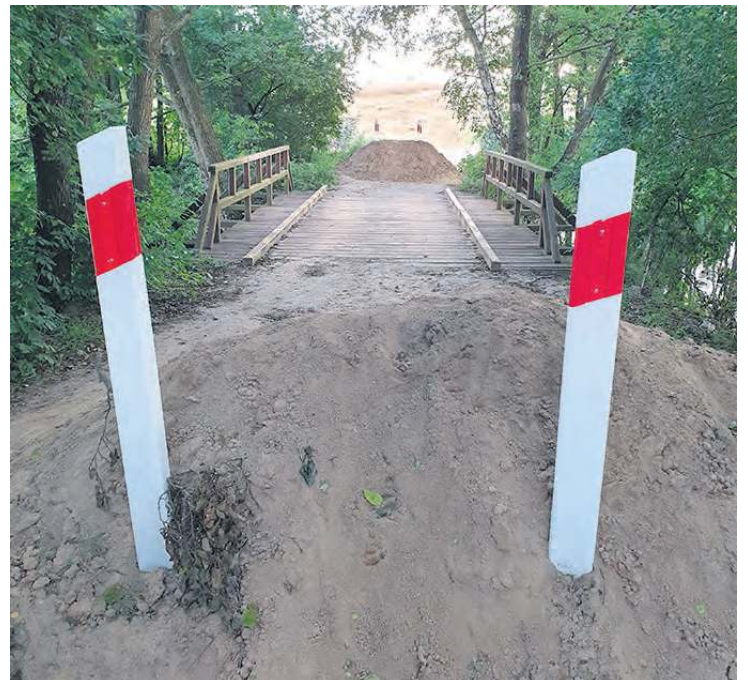
Gmina uniemożliwiła wjazd na most.
