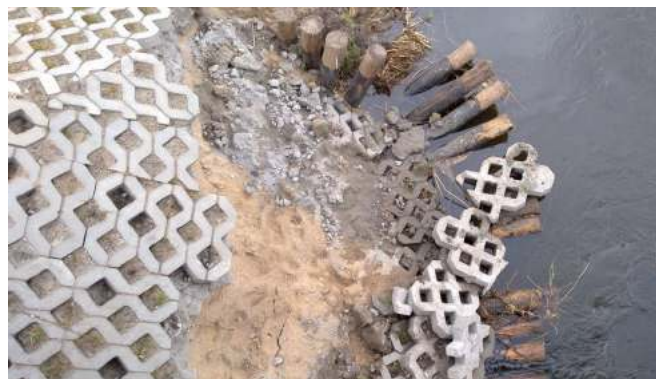
Słabo umocniona skarpa rzeki przy kładce częściowo runęła do wody...
