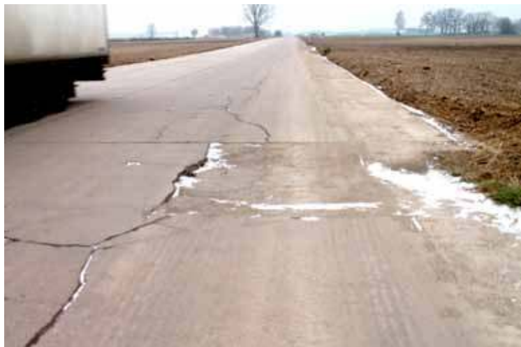
Tiry i inne samochody jadące w kierunku Parku Przemysłowego od strony Os. Lotnisko na Śniadeckiego muszą gwałtownie skręcać, żeby ominąć sporą i głęboką dziurę
