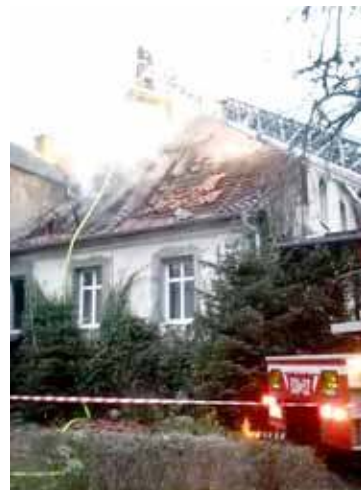
W wyniku pożaru spaleni uległa część dachu. Foto. OSP Marianowo
