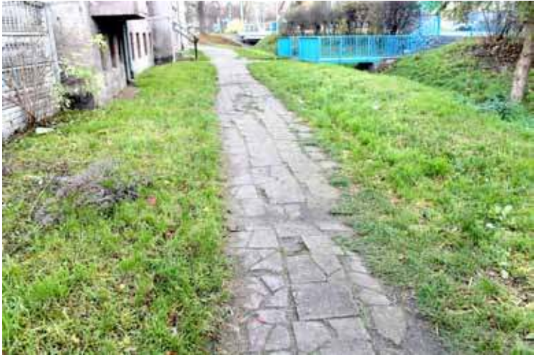
Chodnik jest w fatalnym stanie a chodzenie po nim nie jest dostatecznie bezpieczne, zwłaszcza wieczorami i po opadach deszczu lub śniegu
