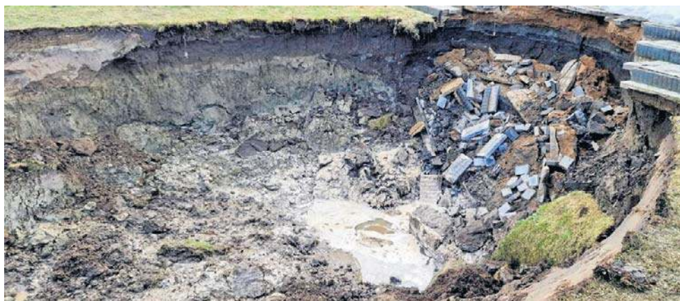
W wyniku tego zdarzenia bezpośrednio zagrożony był budynek mieszkalny znajdujący się w pobliżu wyrwy
