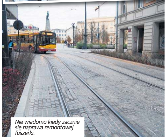
Czy tak powinna wyglądać ulica zaledwie dwa lata po remoncie?
