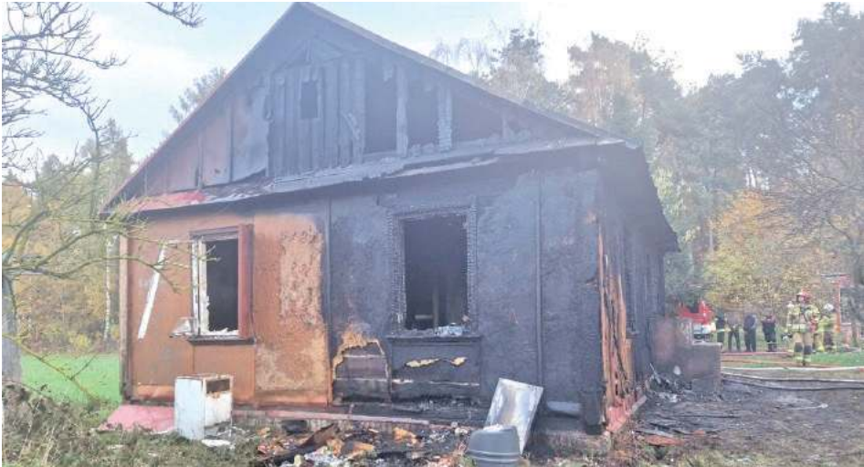
Ogień poważnie uszkodził dom. Jeden z przebywających wewnątrz mężczyzn, opuścił go jeszcze przed przyjazdem służb ratunkowych, drugi został w środku
