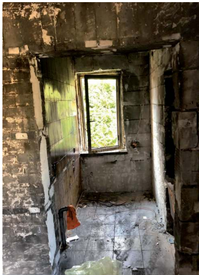
W pomieszczeniach zostały puste ściany. Pogorzelcy muszą wyremontować całe piętro
