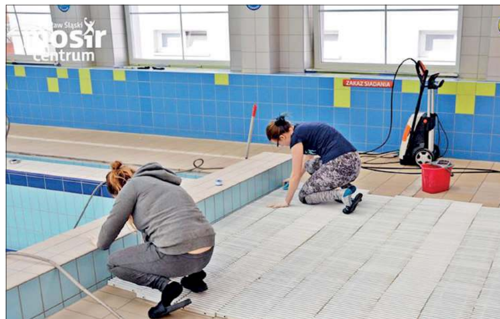
Pracownicy czyszczą całe wyposażenie basenu
