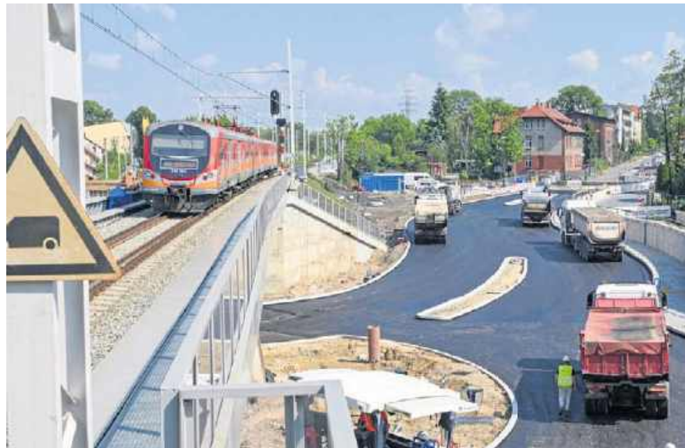
Stacja Łabędy w nowej, przesuniętej lokalizacji, już się wyłania z ogromu prac
