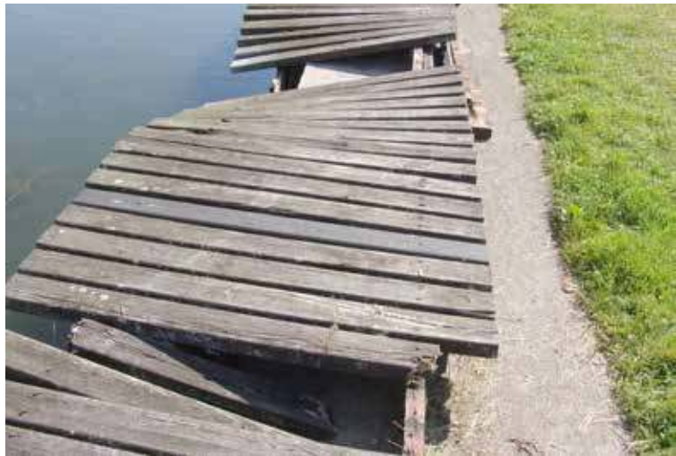
Drewniana konstrukcja jest w coraz gorszym stanie
