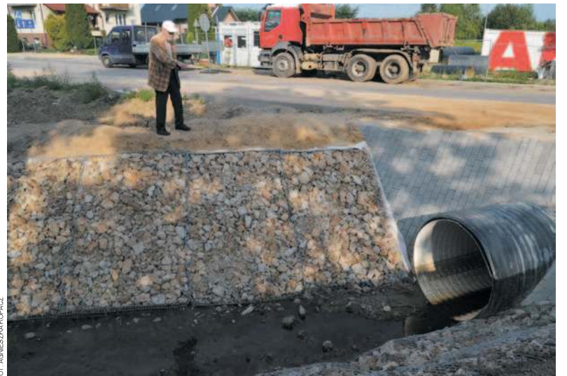
Zdaniem Bogdana Oleszczuka, przyczyną zalewania piwnic w okolicznych domach jest przepust pod budowaną ulicą Modrzewiową
