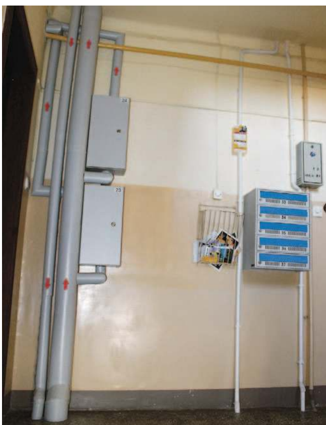
W niektórych blokach mieszkańcy narzekają na estetykę zamaskowania poprowadzonej w nich instalacji centralnej ciepłej wody. Na zdjęciu instalacja c.c.w. biegnąca przez klatkę schodową w wieżowcu przy ul. Okulickiego 4
