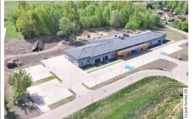
Kompleks żłobkowo-przedszkolny już czeka na jesienne przybycie dzieci. Trwają ostatnie prace przy placach zabaw
