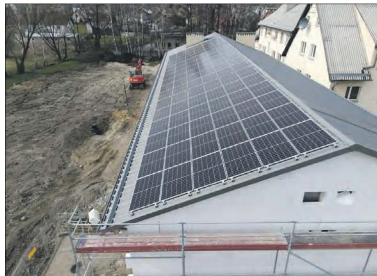
Oszczędniej i ekologiczniej, czyli panele fotowoltaiczne na dachu sali widowiskowej
