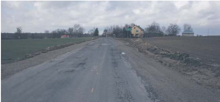
Przerwa w budowie doskwiera najbardziej mieszkańcom Krobonoszy. Maszyny rozjeździły i tak zniszczoną drogę w ich wsi.
