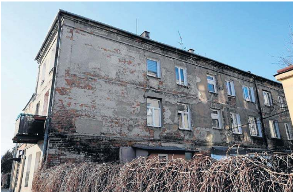
W kamienicy mieszkają cztery rodziny. Dwa lokale są opuszczone. Budynek ma liczne pęknięcia ścian, zapadające się podłogi
